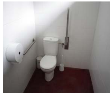
Espai de transferència insuficient
